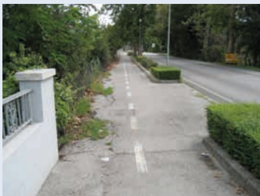
ESEMPIO DI MANUTENZIONE CARENTE
